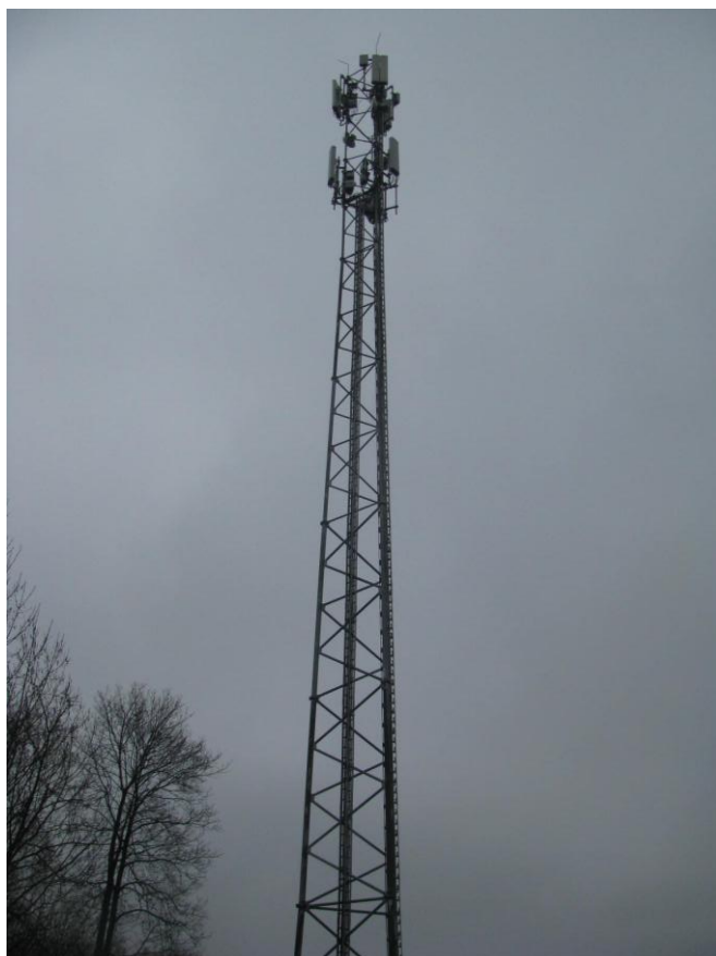
Zał. nr 1: Widok ogólny instalacji radiokomunikacyjnej.
