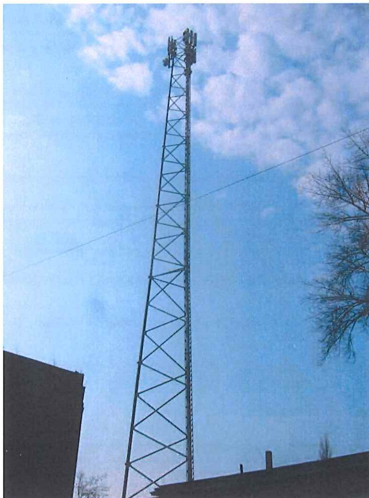
Zal. nr 1: Widok ogólny instalacji radiokomunikacyjnej.
