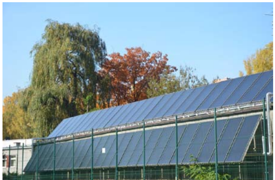
Na kotłowni przy szpitalu zainstalowano 100 solarów
